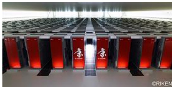
Figure 22 : Le K computer à Kobe
