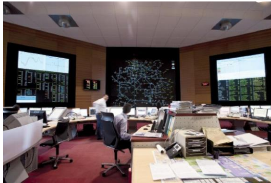
Figure 44 : le centre de commande de RTE
